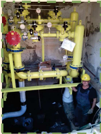
Sostituzione GRF— Italgas
