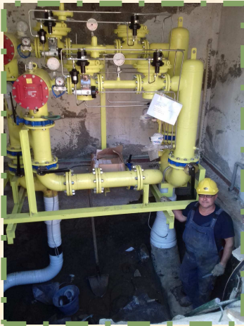
Sostituzione GRF— Italgas
